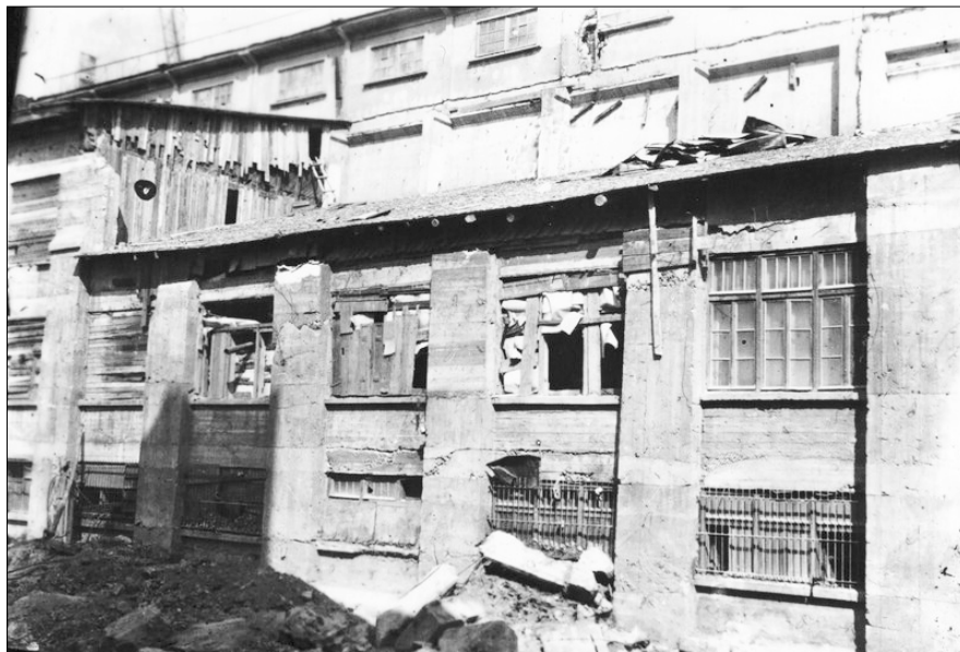
В 1941 году г. Кировск пережил 9 вражеских авианалетов. На фото - здание апатит-нефелиновой фабрики комбината «Апатит» (АНОФ-1) после бомбардировки 28 июня 1941 года.
